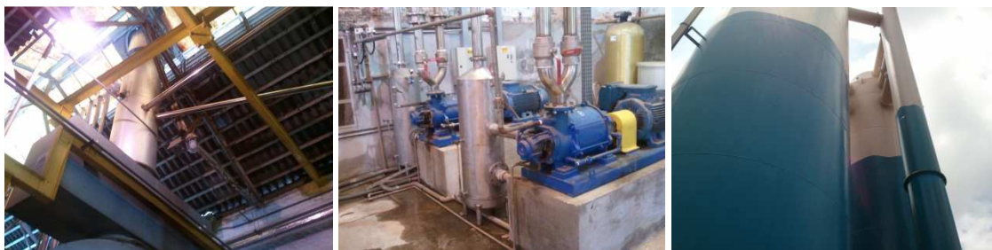
Figuras 24a: Tubulação do desvio de saída dos gases da caldeira; 24b: duas bombas com refrigeração acoplada, localizadas logo após as tubulações de desvio do gás; 24c: reatores de neutralização. Fonte: fotos do autor.
